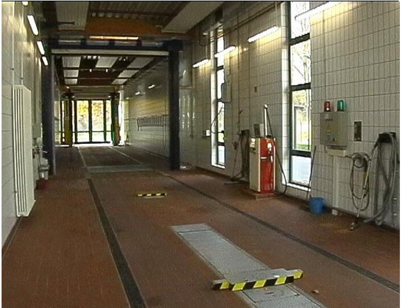
WASCHHALLE für Nutzfahrzeuge mit Portalwaschanlage mit "Unterboden Hochdruckanlage"
