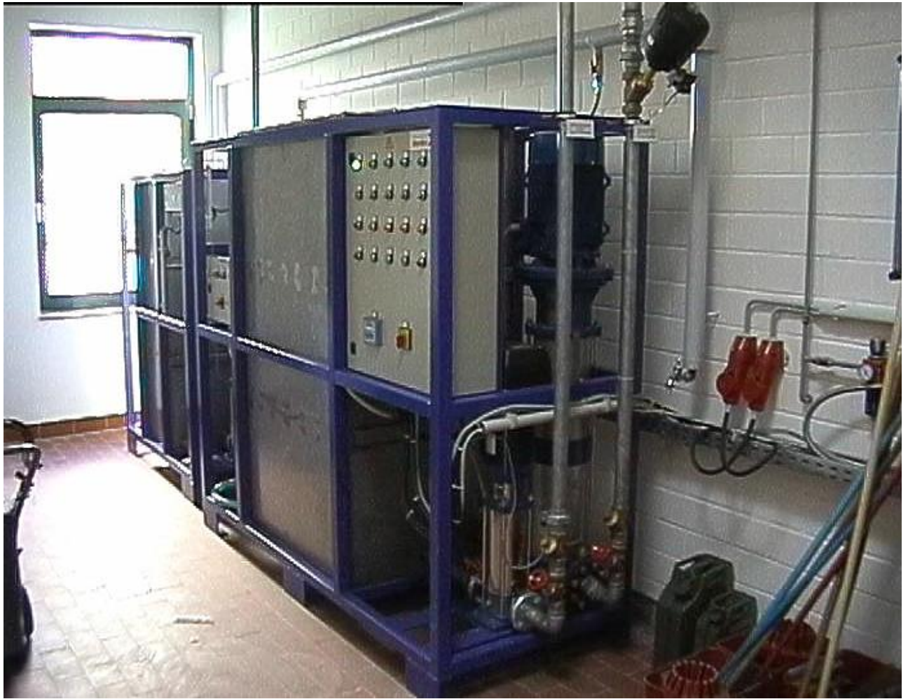
Technikraum mit Brauchwasserrecyclinganlage und Regenwasserzentrale
