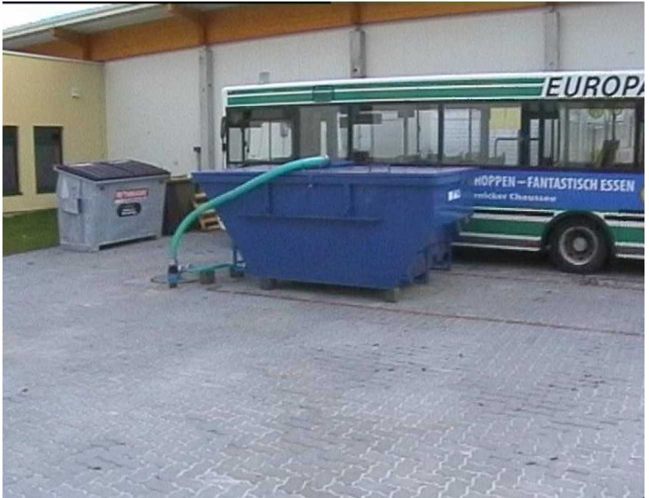
Automatischer Schlammaustrag mit Entwässerungscontainer ( EWC )
